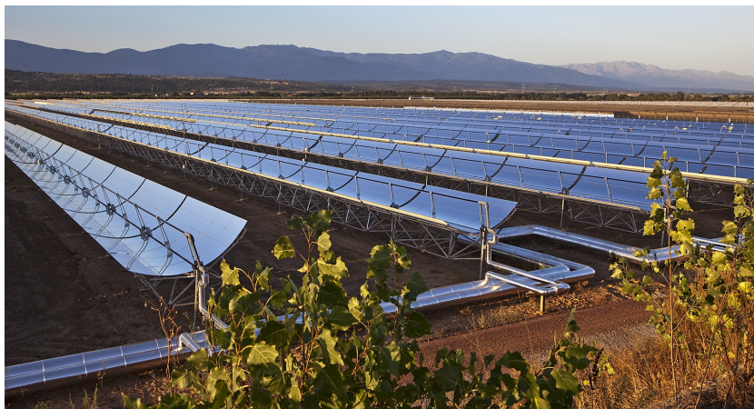
Fig. 2.5: Centrale solare a concentrazione parabolica, compagnia "Acciona", Sudafrica.
