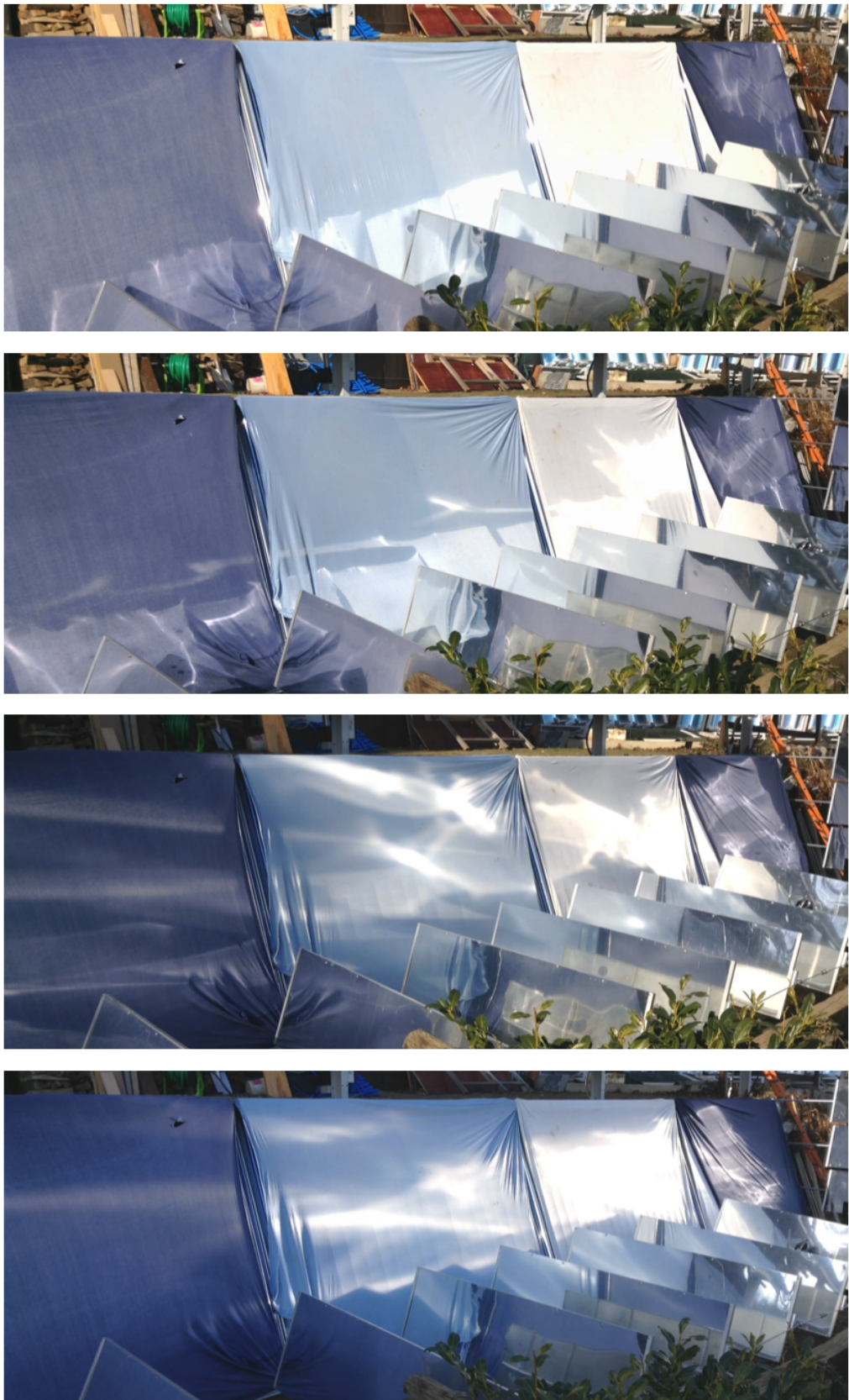
Fig. 4.2: Secondo test dell'impianto (04.02.2018).
