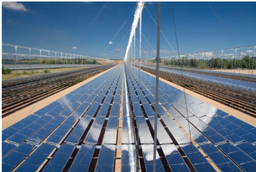
Figura 7: L' impianto costruito dalla AUSRA in New South Wales, Australia, è capace di sviluppare una potenza di 9,3 MW grazie una superficie riflettente di 18'500 m 2 ed è un esempio calzante di collettori lineari a lente Fresnel. Infatti, nell'immagine si può vedere la diversa angolatura degli specchi piani e il ricevitore in alto, simile ai collettori parabolici lineari. Fonte: [H], [I].
