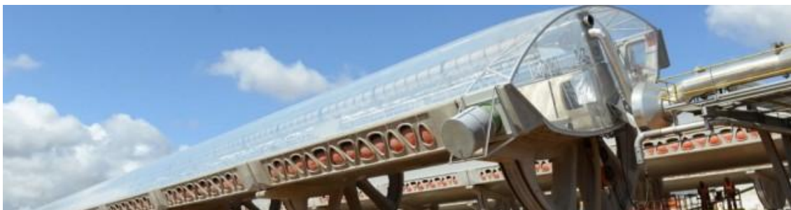
Figura 1: Concentratore solare a forma di gronda ad Ait Baha, Marocco. Date le sue enormi dimensioni (215,5 m di lunghezza e una superficie riflettente corrispondente a 2053,3 m 2 ), la struttura è in grado di sviluppare picchi di potenza termica di 1,3 MW. Fonte: [A].
