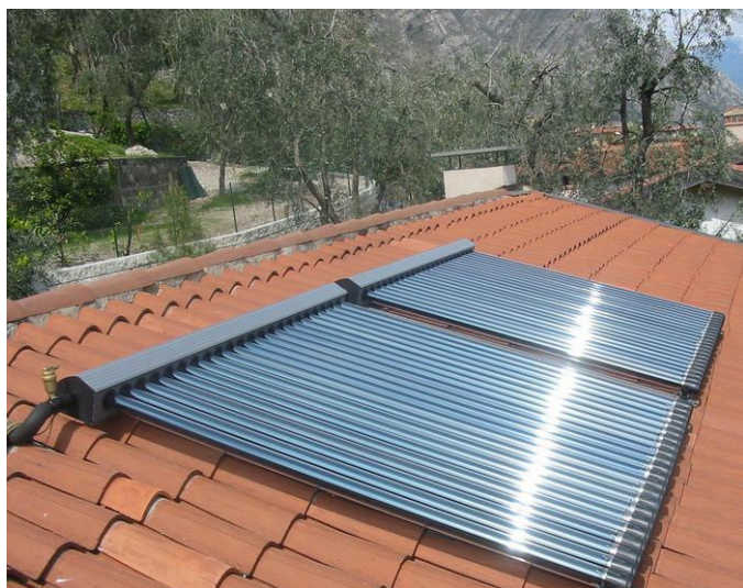
Figura 2.11: impianto di collettori solari non vetrati montato su di un tetto.
