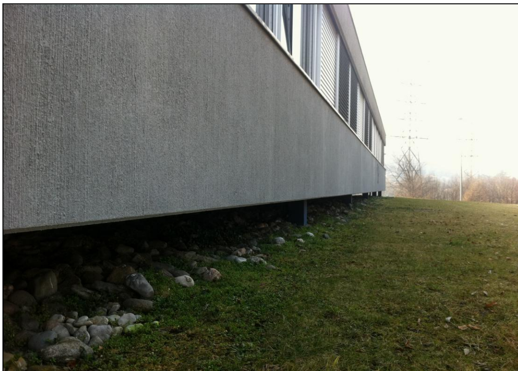
Figura 4.9: stabile del liceo - piano rialzato di scienze, energeticamente dispersivo.
